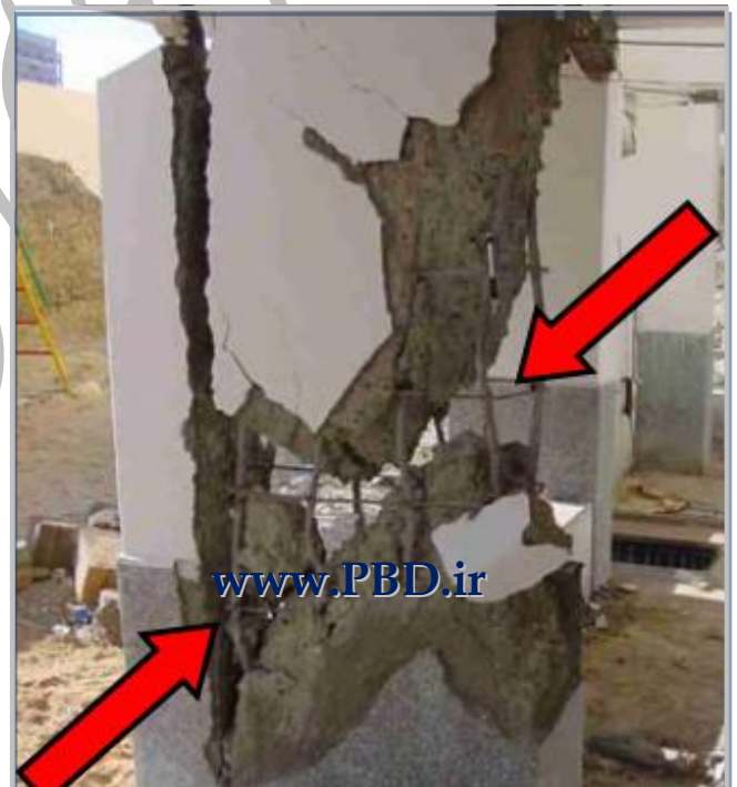
شکل ۳: ترک مورب خسارت غیرمطلوبی است که باربری ثقیل ساختمان را مختل می‌کند
